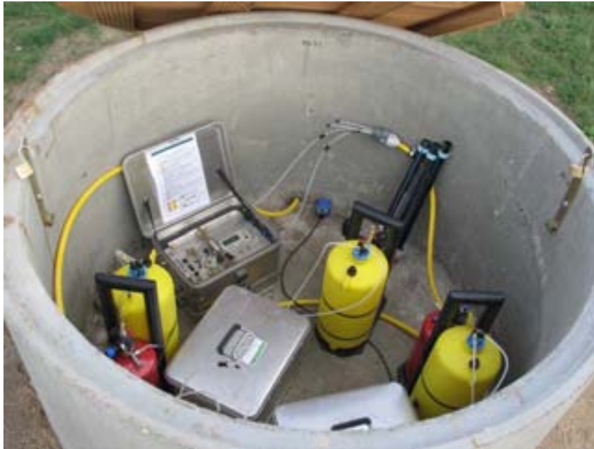
Abb. 4.2-4: Messschacht mit Messgeräten für die Linienvermessung
